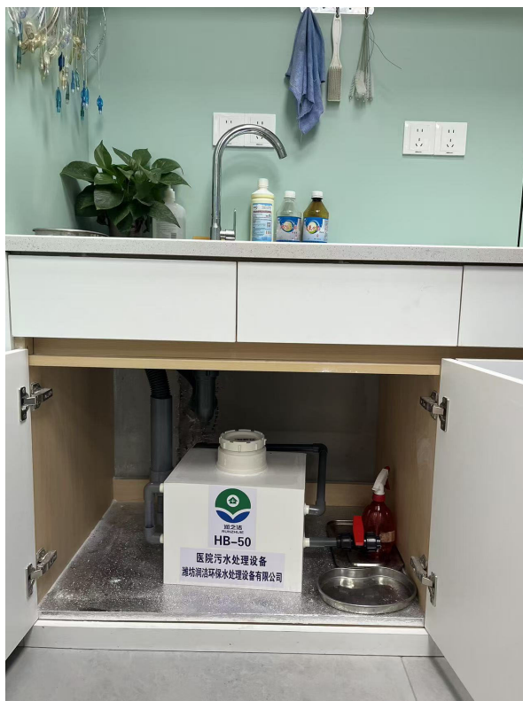
手术室废水消毒设施
