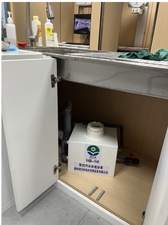
中央处置区废水消毒设施
