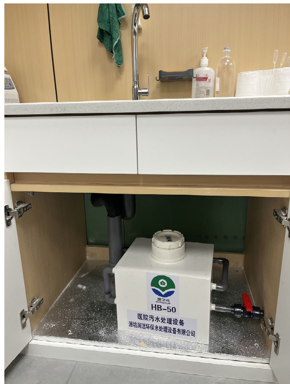
化验室废水消毒设施
