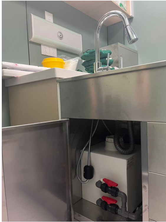
手术准备室废水消毒设施
