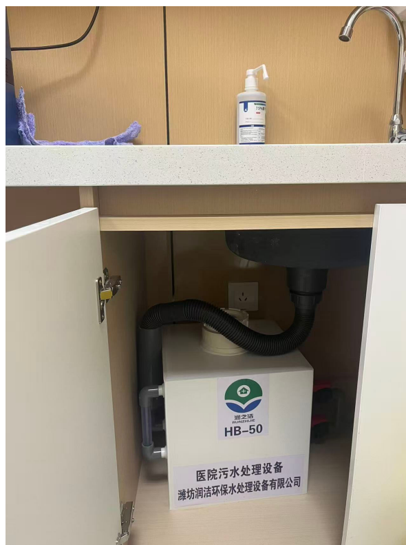
化验室废水消毒设施
