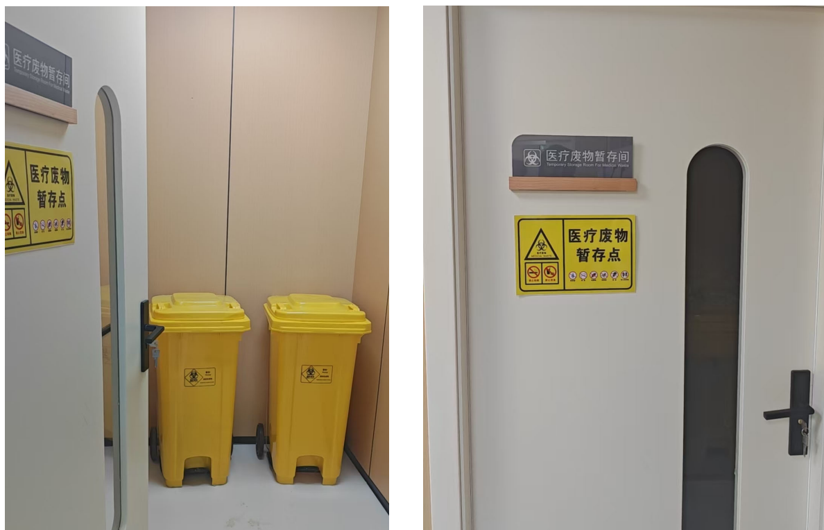
医疗废物暂时贮存设施
