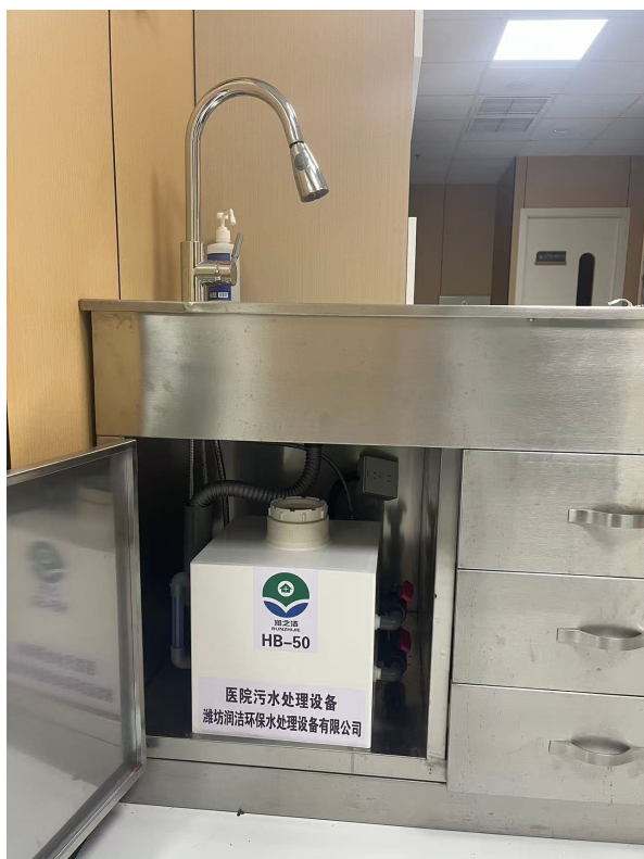
中央处置区医疗废水消毒设施
