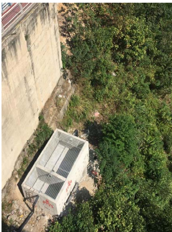
西桥头事故池
