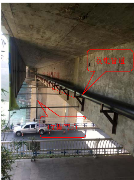
事故废水收集管道
