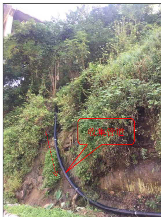
事故废水收集管道
