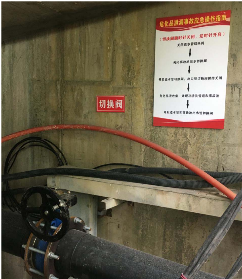
应急操作流程现场照片
